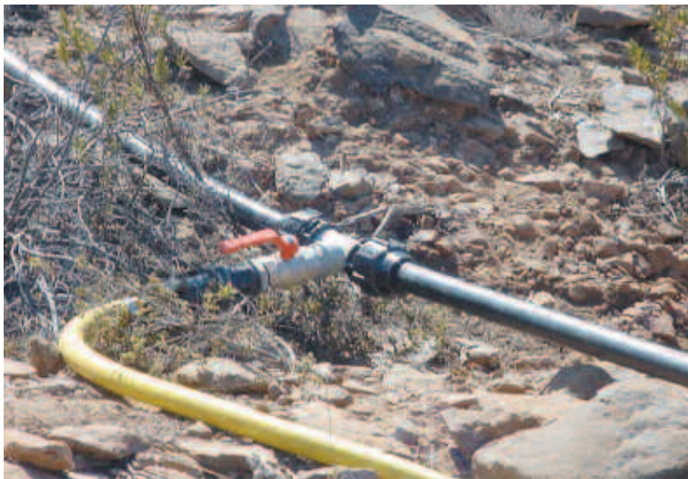
Detalle de línea principal con bifurcación para manguera de riego.
