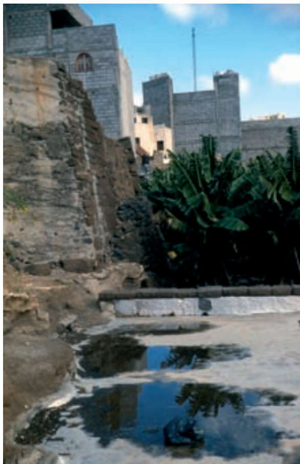
■ Foto 17. Cubierta de hormigón instalada sobre la Cueva Pintada en la que se observa un encharcamiento provocado por la lluvia.
