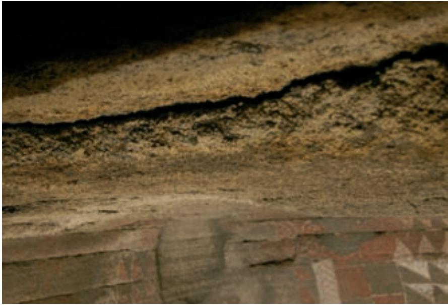
■ Foto 5. En la fotografía se puede apreciar el despegue existente en el techo pintado.
