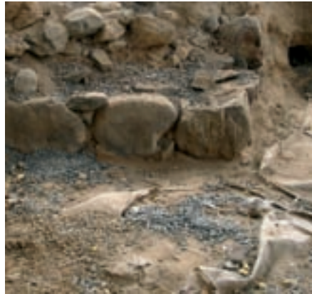
■ Foto 9. Ejemplo de degradación en una estructura.
