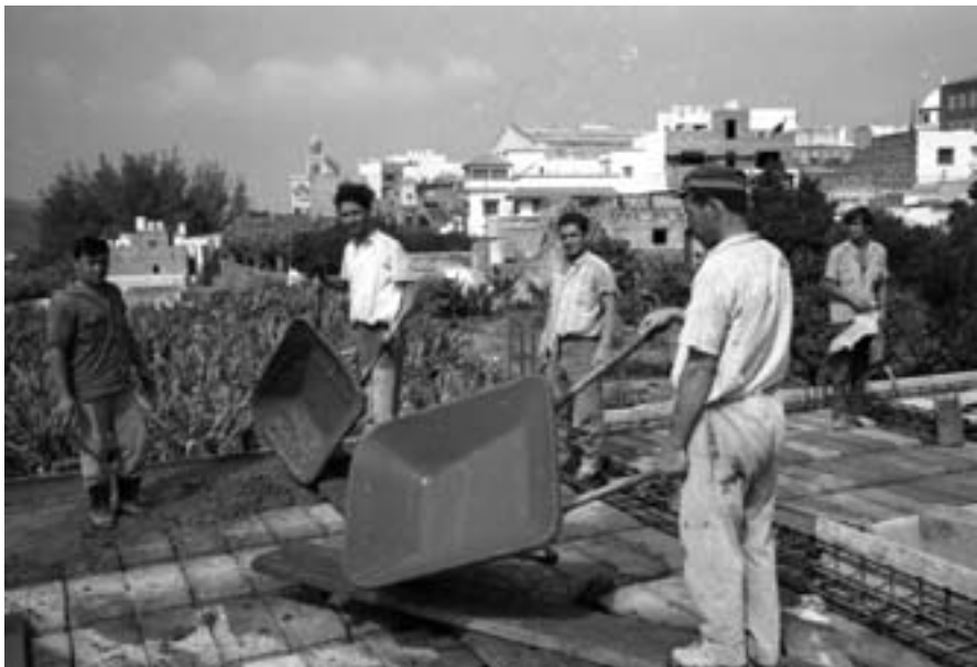
■ Foto 12. Construcción de la plancha de hormigón con la que se cubre la Cueva Pintada después de los trabajos de 1970.
