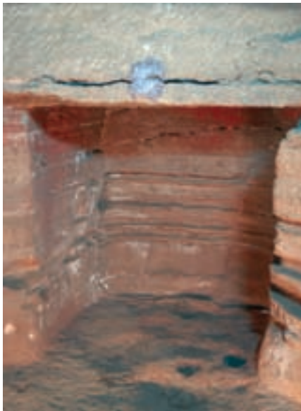
■ Foto 6. Detalle de la fisura de una de las cuevas anexas; en el centro se observa un testigo de cemento colocado el año 1980.
