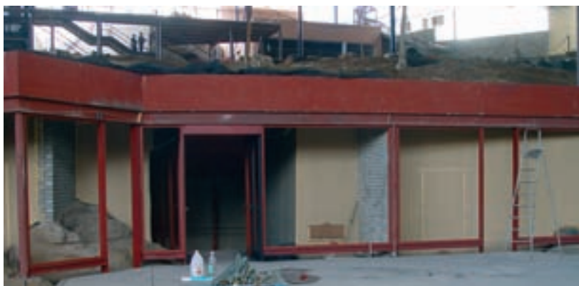
■ Foto 20. Detalle de la instalación de la estructura de la fachada del cierre de la cueva.
